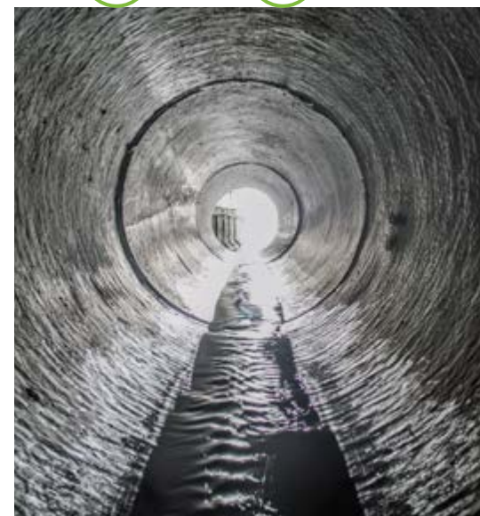
Rund 10.000 km Berliner Abwasserkanäle müssen im Blick behalten werden, um Schäden rechtzeitig sanieren zu können.
